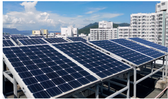
房屋委員會在水泉澳邨安裝的太陽能發電系統
