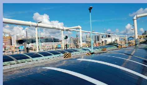
昂船洲污水處理廠的薄膜太陽能光伏系統
