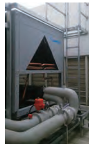
安裝了可變速 驅動器的空調系統
