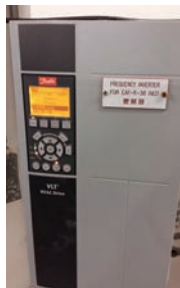
安裝了可變速驅動器的空調系統
