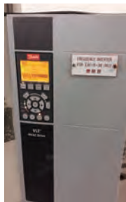
安裝了可變速驅動器的空調系統
