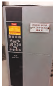
安裝了可變速 驅動器的空調系統
