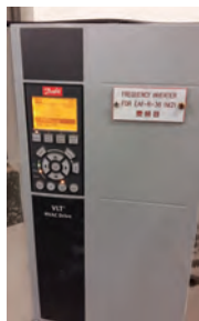
安裝了可變速驅動器的空調系統
